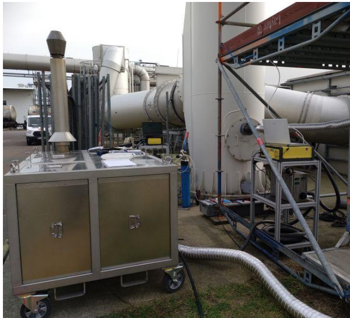
Abbildung 17: Realversuche: Katalysepilotanlage links, FTIR rechts (Rohgas) und im Hintergrund (Reingas)
