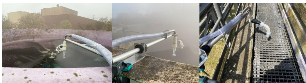
Abbildung 9 links, Mitte: Probenahmeeinrichtung am Auslass einer VKA, rechts: oberhalb eines Lufteinlassgitters
