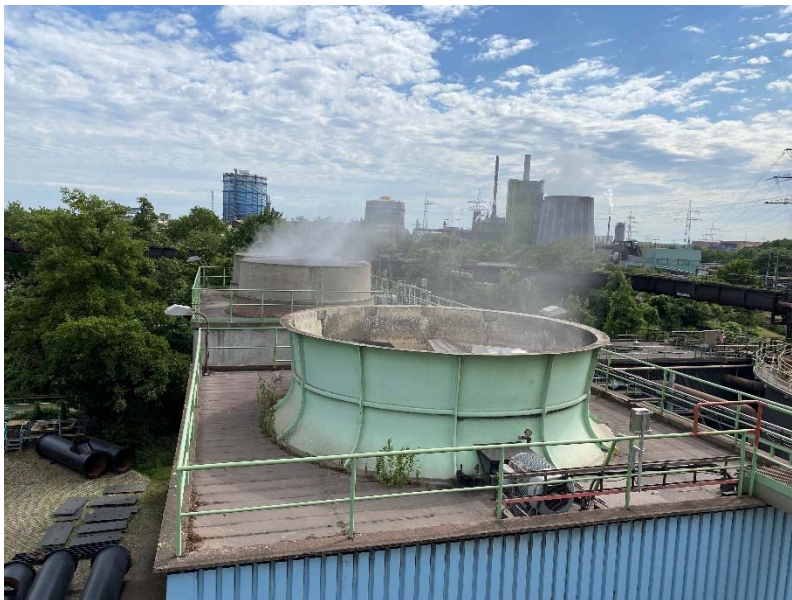
Abb. 1: Auslassebene von Zellenkühltürmen mit saugend angeordnetem Ventilator
