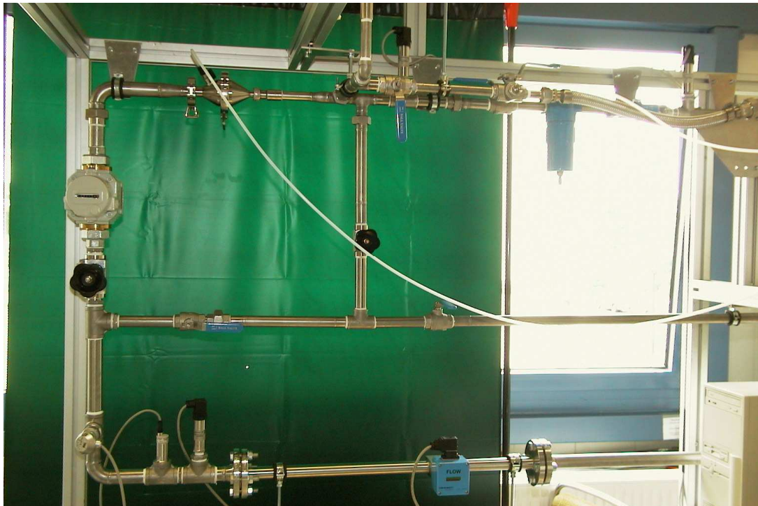
Abbildung 33: Teil des Prüfstandes zur Aufbereitung der Luft und Regelung des Volumenstromes
