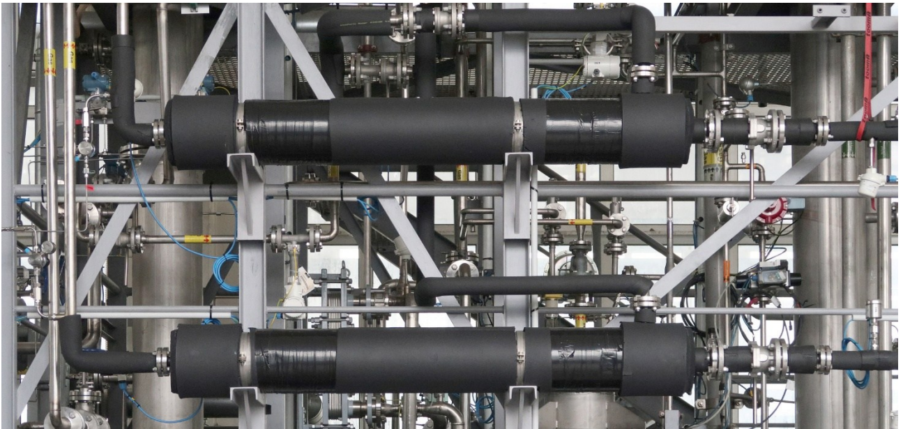
Blick in die Druckgaswäsche im Technikum des IUTA
