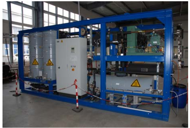
Bild 4-79: Vordere Seitenansicht der Testadsorberanlage
