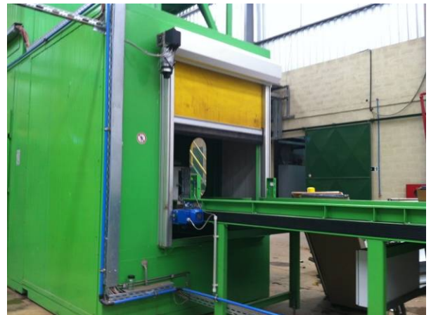
Bild 4-76: Anlage zur weiteren Behandlung der Kühlschränke in Stufe 2
