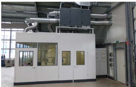
Bild 4-5: Be- und Entlüftungsanlage
