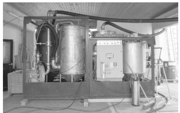
Bild 4-52: Praxisversuche mit der Absorptionsanlage am BHKW eines Klärwerks
