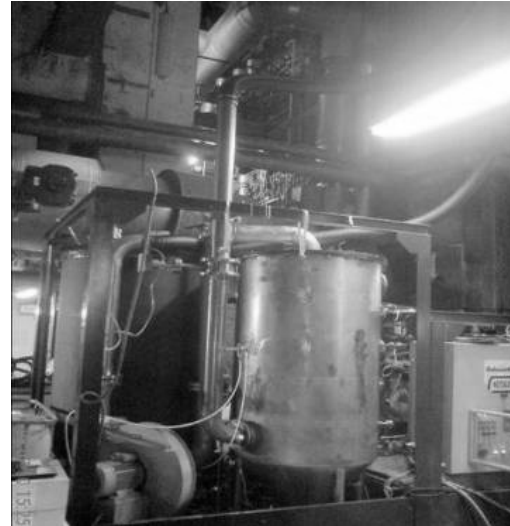
Bild 4-53: Reinigung im Versuchswäscher (rechts) am Kraftwerkstandort
