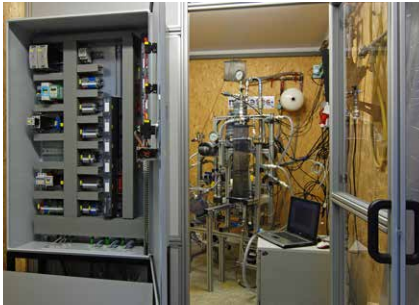
Bild 4-62: Container der Demonstrationsanlage mit AKM (hinten) und Schaltschrank (vorne links)
