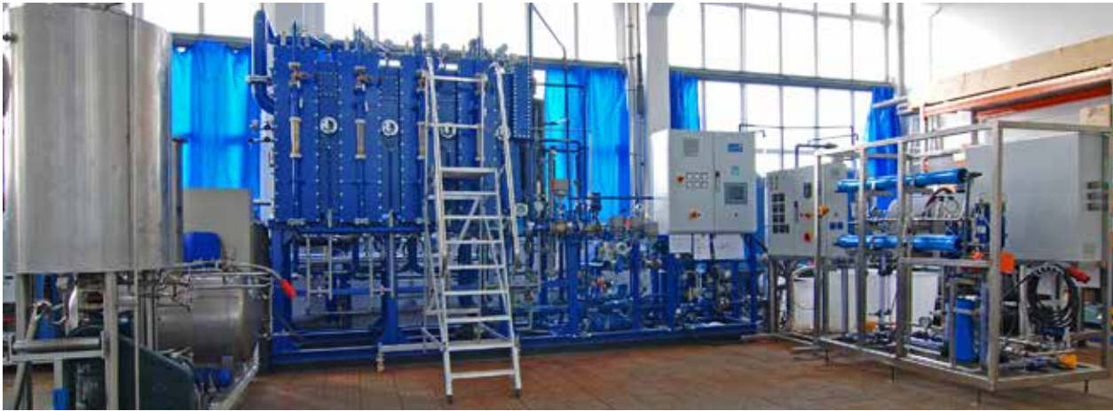
Bild 4-90: Technikumsanlagen der Wasser-Prozess-Technik bei IUTA
