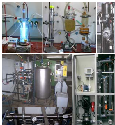
Labor- und Pilotanlagen zur oxidativen Abwasserbehandlung
